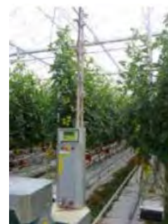
Appareil de traitement sous serres
