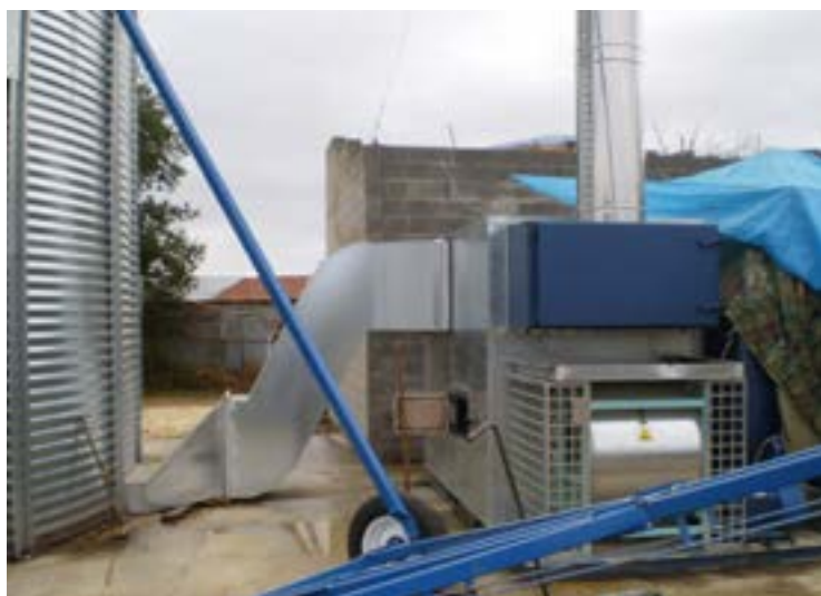
Le générateur d'air chaud avant la construction de l'abri
